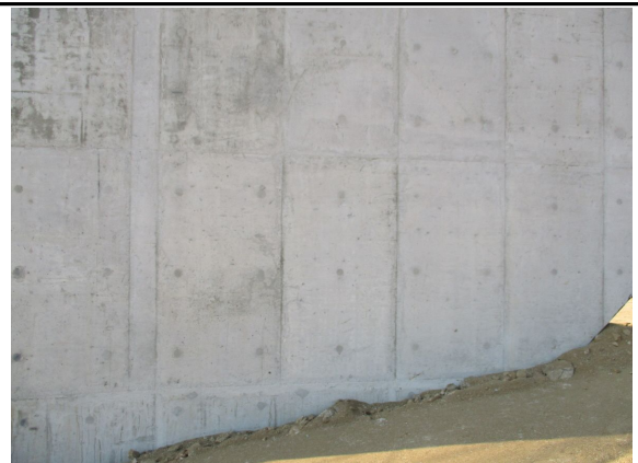
교대 A2 날개벽 상태 전경(점검일:2015.11)
