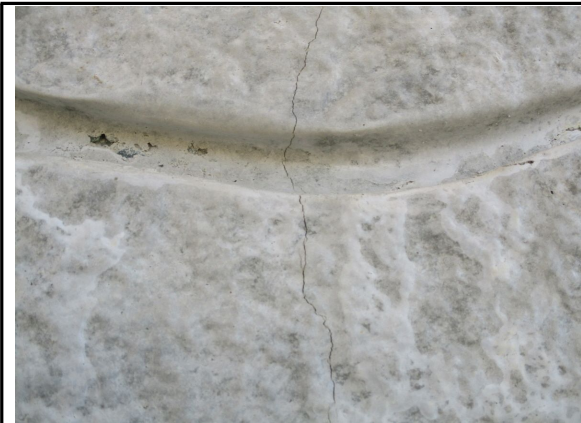
교대 A1 전면 균열 발생(점검일:2015.12)
