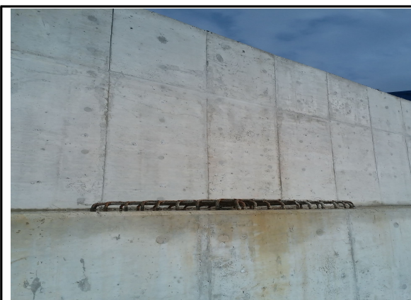
교대 A2 파라펫 상태 전경(점검일:2015.11)
