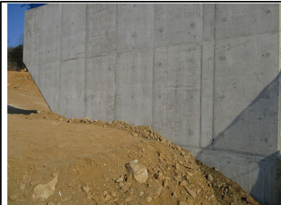
교대 A2 날개벽 상태 전경(점검일:2015.11)
