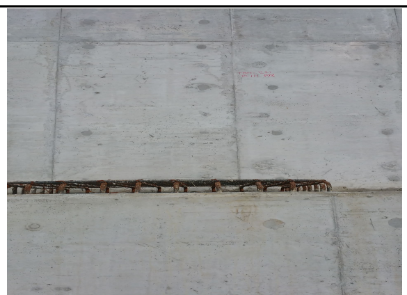
교대 A2 파라펫 상태 전경(점검일:2015.11)
